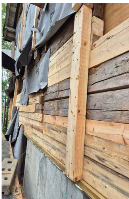
Mye av det opprinnelige trevirket var i for dårlig stand til å gjenbrukes. Det er erstattet med trevirke fra andre steder på huset, eller fra Toftegaard Trelast.
