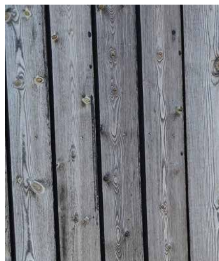
Vegg med brent og børstet malmfuru kledning fem år etter montering.
