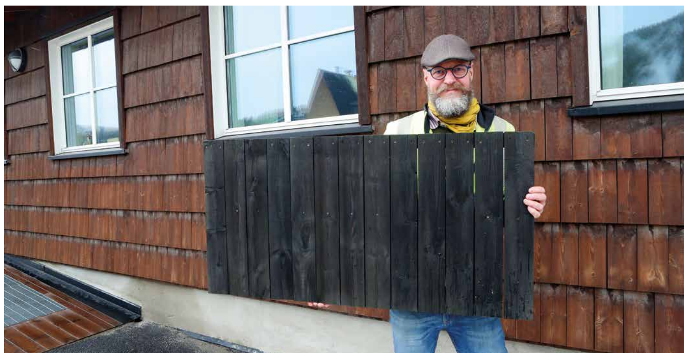
Her holder Asmund Vårtun en ramme med spon. – Når slike rammer blir festet på en vegg, kommer veggen til å bli omtrent som den jeg har bak meg her på administrasjonsbygget til Alvdal Skurlag.
