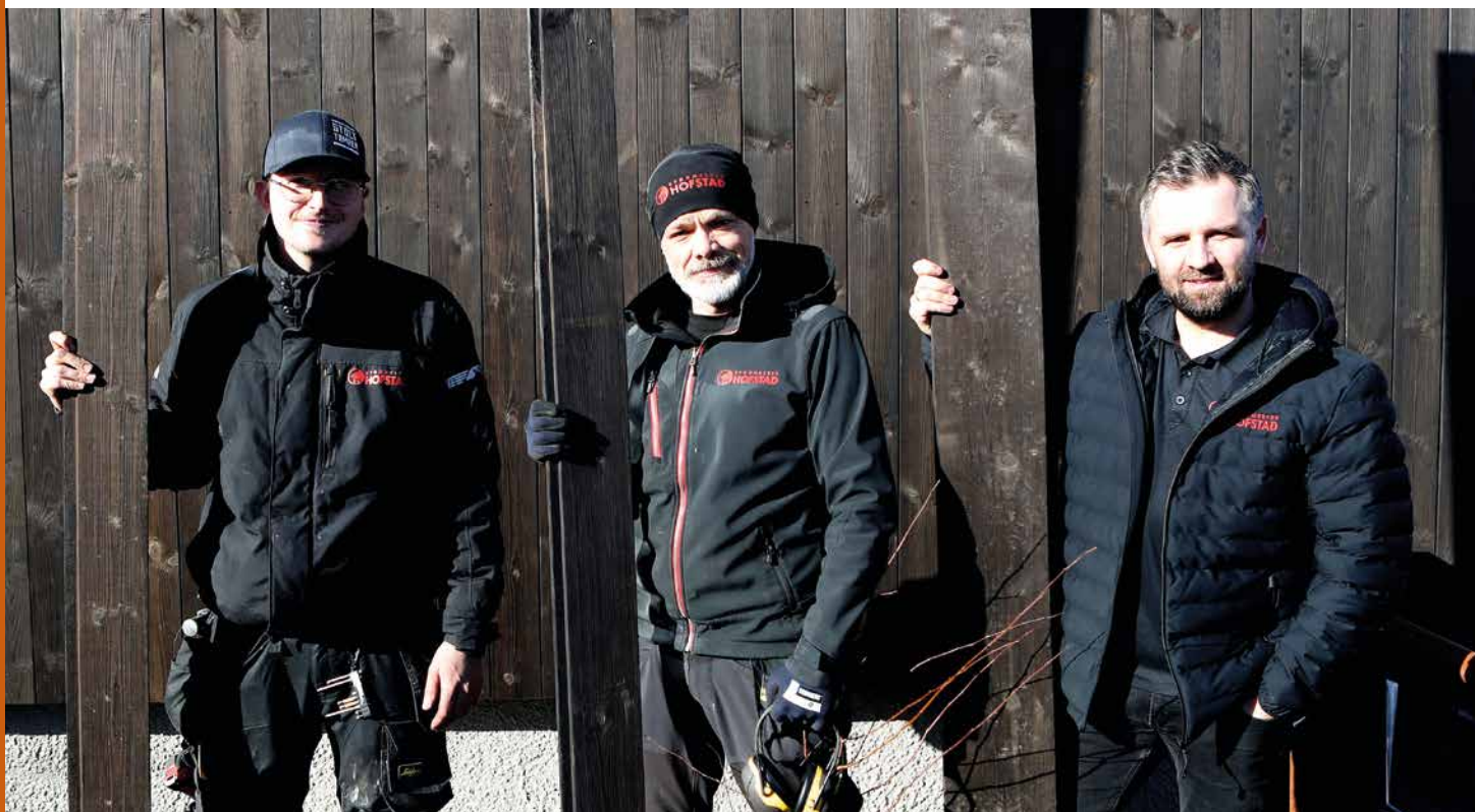
Tømrerlærling Petter Kristoffersen (t.v.), bas Marcin Golema og prosjektleder Sandis Auzenbergs som også er byggmester, (t.h.) foran en del av veggen mot nord som er nærmest ferdig kledd med brent panel.
