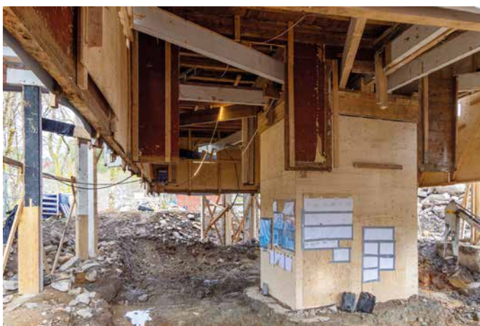
Sveitserhuset ble løftet opp fra bakken med ombrukslimtref og stod slik i fire måneder.
