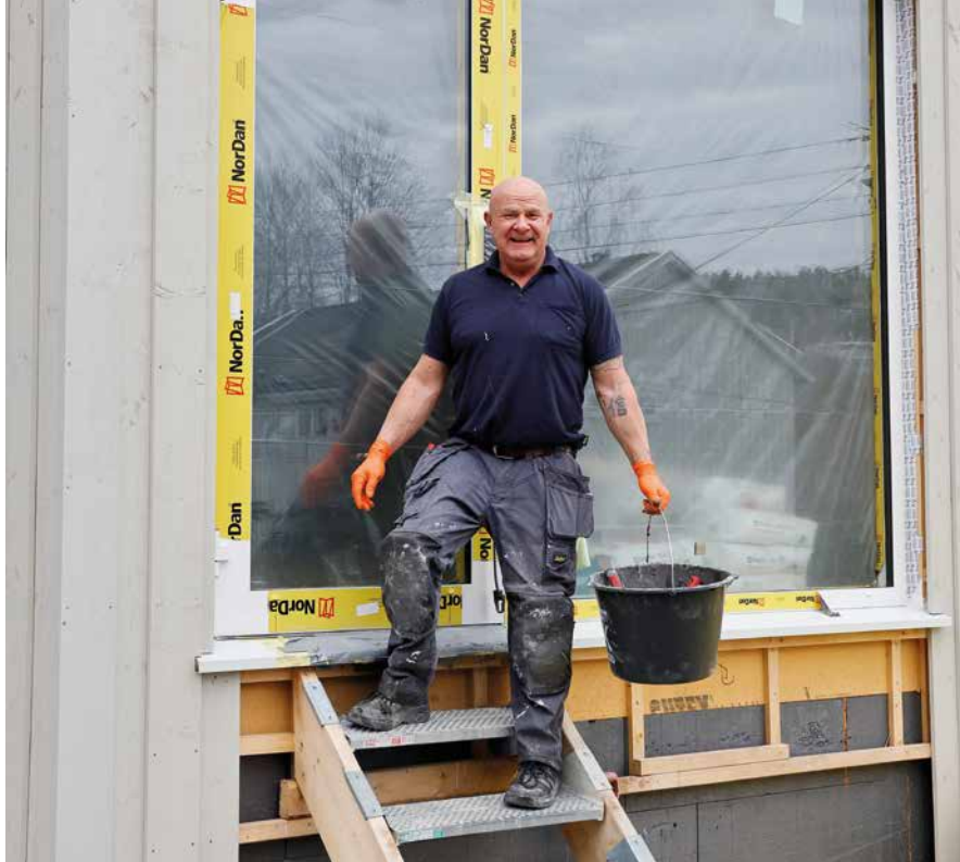
- Så lenge det puster hele veien, har jeg tro på disse materialene. Jeg synes vi bygger for tett i dag, sier tømremester Bjørn Andresen.
