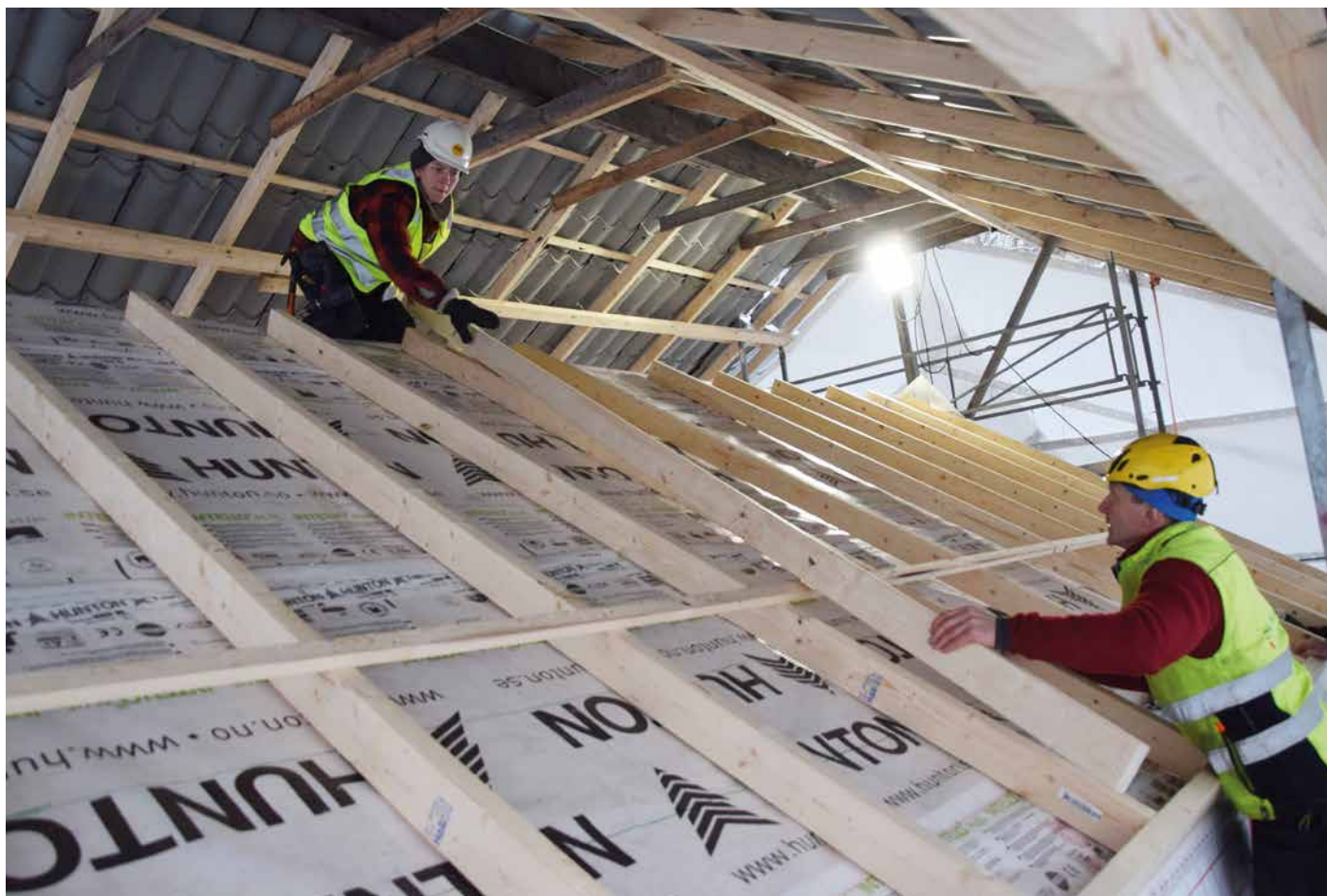
NYTT TAK: Oppå det gamle taket skal det legges vindtetting og et lag isolasjon. Linus Olhans og Stig Arve Amdal legger opp til påforingen.
