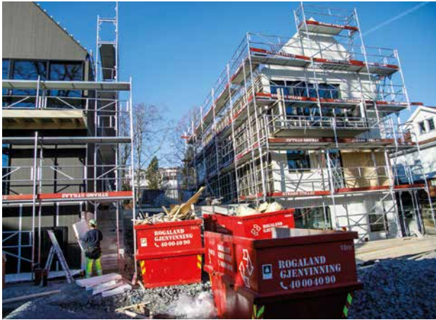
Tomta er relativt romslig til å ligge inne i en by. Derfor er det god nok plass til blant annet sortering av byggavfall.
