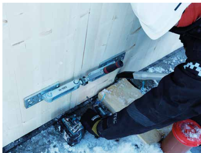
Sammentrekking av elementer med spesielle spennverktøy som benyttes på massivtre og limtre. (Foto: Olav-Inge Alfheim)
