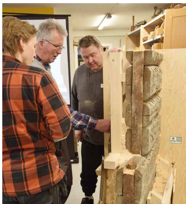
NY ISOLASJON: Kursleder Per Willy Færgestad (midten) diskuterer hvordan en gammel tømmervegg kan isoleres innvendig og utvendig med kursdeltakerne Linus Olhans og Ulf Koritzinsky.
