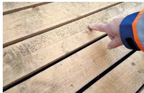
Skurlasten har en ru overflate som trekker til seg kondensen fra undersiden av metallet. Når sola kommer, varmes konstruksjonen opp, og fukten fra kondensering fordamper.
