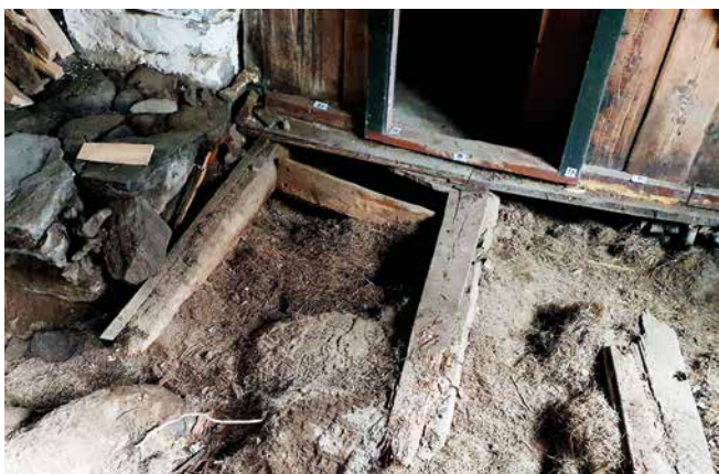
Det var svært mye råte enkelte steder. [Foto: privat]
