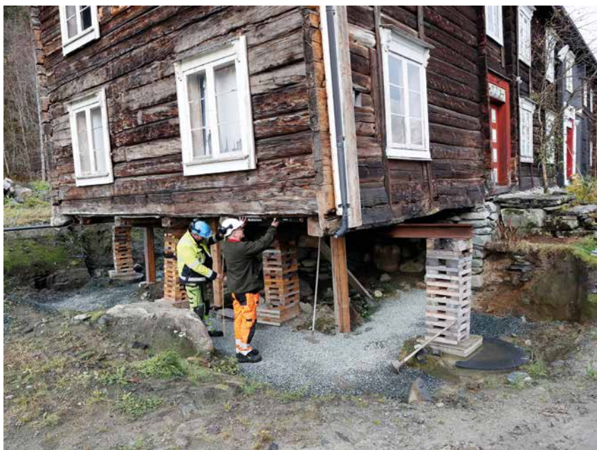
Her var grunnmuren på trønderlåna svært dårlig. Magne Vidar Rise (t.v.) og Stein Havdal måler og vatrer. Det skal støpes fundament og bygges Leca grunnmur.
