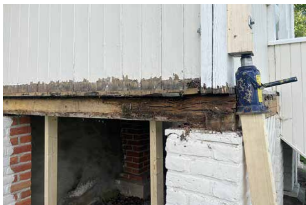
RÅTTEN SVILL: På den ene kortveggen var bunnsvilla råtten. Det var årsaken til at verandaen var skeiv. (Foto: Eirik Gimle)
