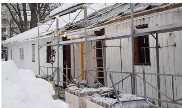
SIGEN: Oppretting er begynt, men det er tydelig å se at bygget har seget rundt åpningen.
