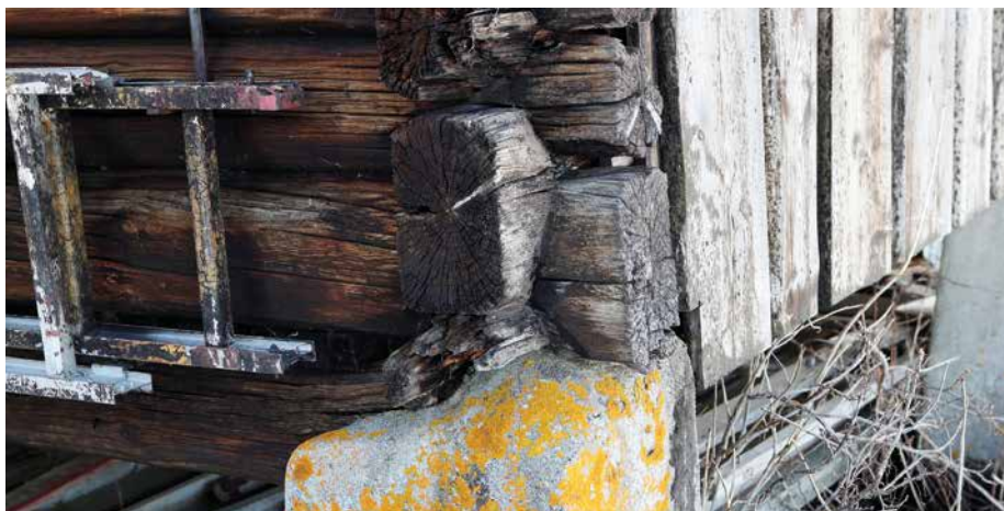
Her ser vi en del av råteskadene på det største stabburet.
