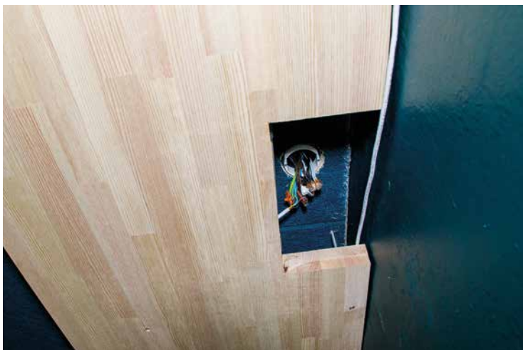
Strømuttak er i så stor grad som mulig skjult bak himlinger og flåter.
