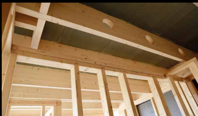
Gjennomføringer til ventilasjonsaggregat med varmegjenvinning.
