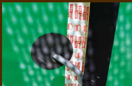
Isolert gjennomføring for strøm og styring av solskjerm.
