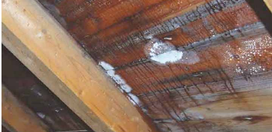
Kondens på undersiden av taktro. (Foto: Byggforskserien)
