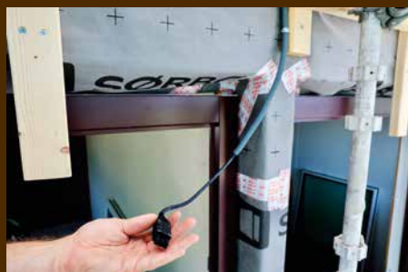
Kontakt til strøm og styring av solskjerm. Montøren plugger bare i kassetten.
