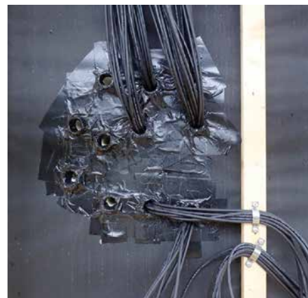
Massiv bruk av teip for å tette rundt kabelgjennomføringer til solcelleanlegg på fasade. Det er teipet på et stort område, noe som krever at teipen er dampåpen. [Foto: Tore Kvande/NTNU]
