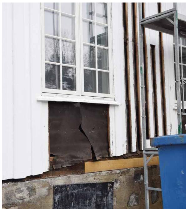
Det meste av kledningen holder fortsatt i lang tid. Bare råteskadde deler tas ut.
