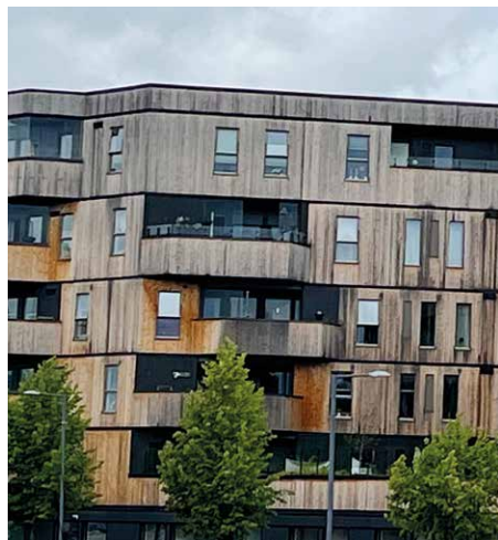
En trekledning i ferd med å gråne naturlig. Overbygg skjermer mot fuktbelastning, og store glassflater øker belastningen nedenfor. (Foto: Frank Ivar Andersen)
