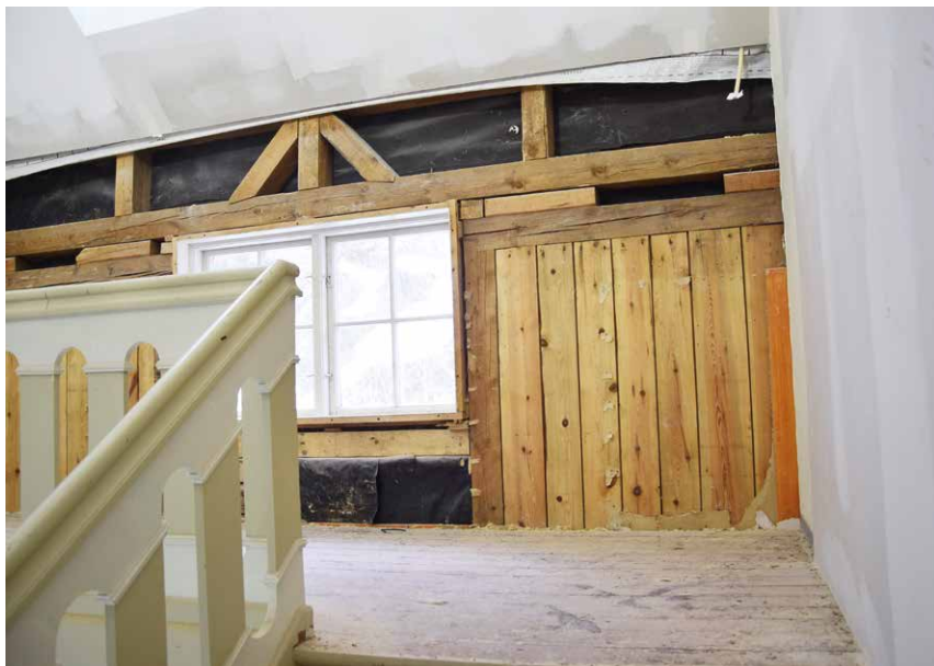
Gammel kledning er ribbet av veggene som er bygd med kraftig bindingsverk og stående plank. Nå skal veggene fores ut med 5 cm isolasjon.
