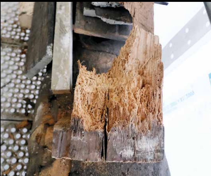
Angrep av råtebille og ekte hussopp.
