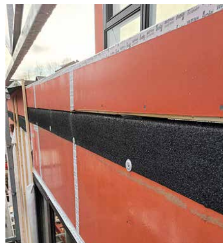
Morten Hommes løsning med GU-gips på vegg og parapet. Mellom dampsperra og parapet er det ei lita glippe. (Foto: Morten Homme)
