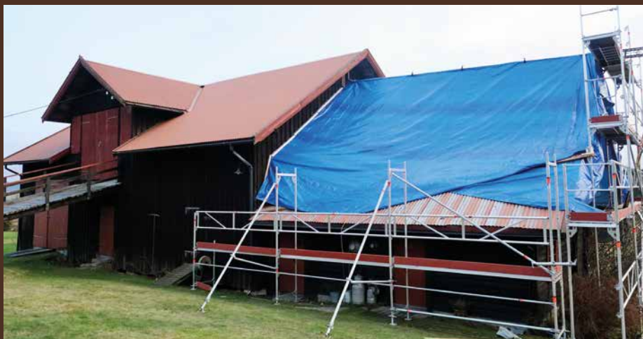
Råteskadet: Stokker i den eldste delen av fjøset skal restaureres. Disse skal Abrahamsen hente i Holtops egen skog og så tørke før bruk, slik eier gjorde forrige gang.
