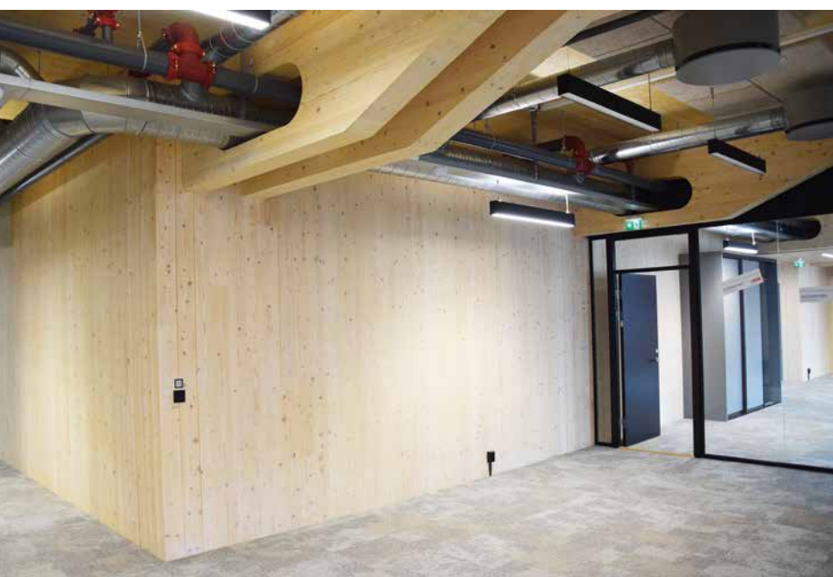
Treverket er en viktig del av interiøret. Derfor måtte alle ta hensyn til at overflatene var ferdig behandlet og ikke måtte få skader. Ventilasjonsrør ligger synlig, elektrisk anlegg er lagt utenpå så endrede rominndelinger kan gjøres enkelt.
