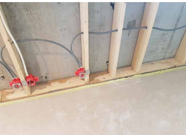
Betongveggen og svilla har merker av kondens og fukt. Det var ikke lagt grunnmurspapp under svillene. (Foto: Øyen)
