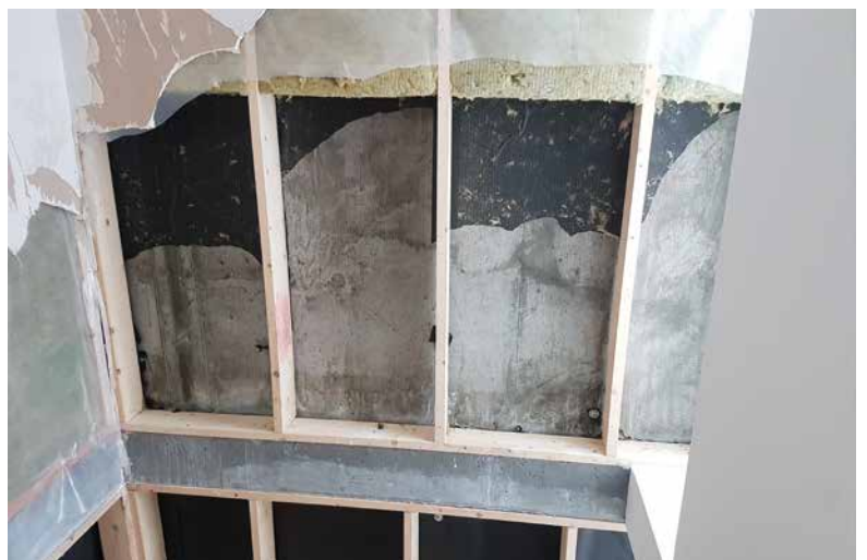
Det var lagt forhudningspapp og isolasjon på innsida, men ingen isolasjon på utsida. (Foto: Øyen)
