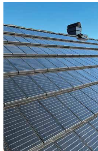
Solcellene er integrert i taksteinen.
