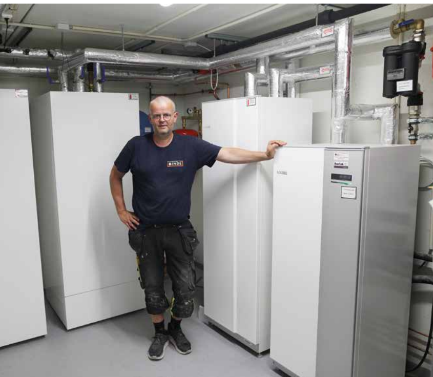
Jørgen Binde ved jordvarmeanlegget i det tekniske rommet til borettslaget.
