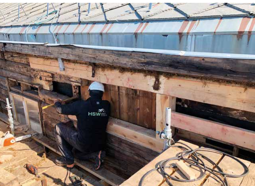
En del råteskader i veggen måtte utbedres. (Foto: Byantikvar Magnus Borgos.)
