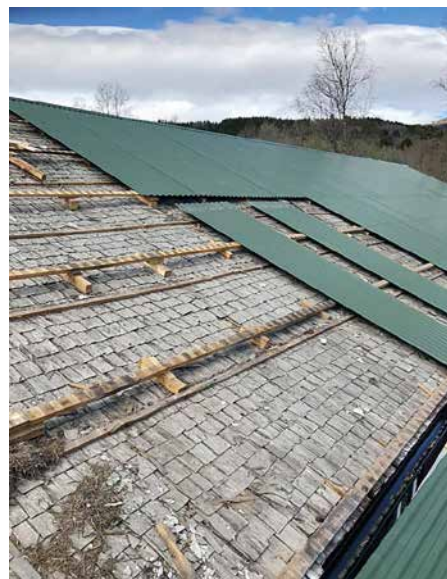
Det gamle spontaket på Isolatbrakka kommer til syne under bølgeblikk-taket. [Foto: Klungset Leir AS]
