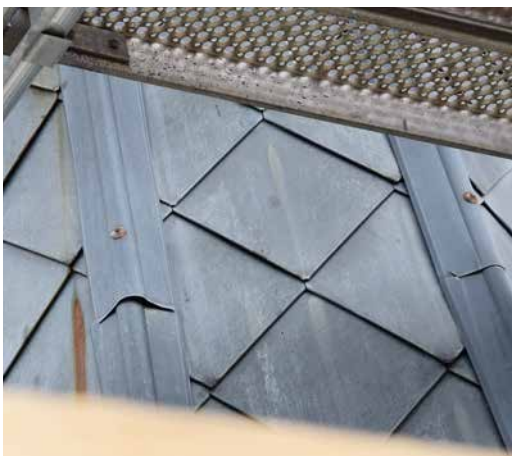
Taktekkingen er av nyere dato, men beslagene lå feil så vann kunne trenge inn.
