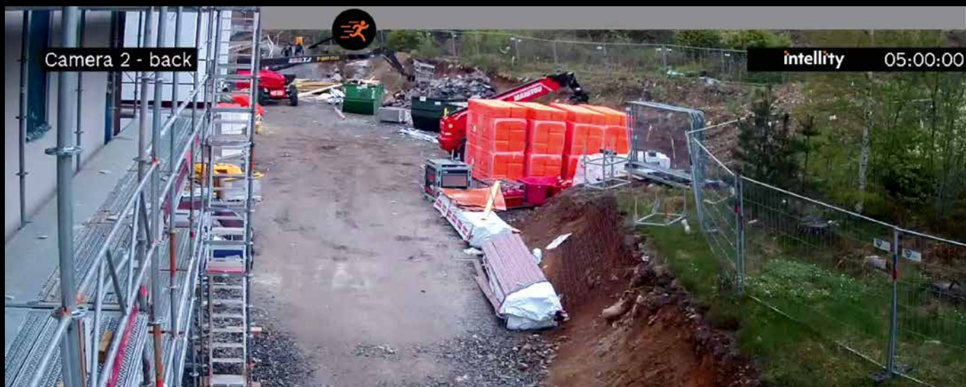
Kameraet har fanget opp en person og markerer det i bildet. Personen legger på sprang når alarmsentralen varsler over høyttaleren at han er observert. (Begge foto: Intellity)
