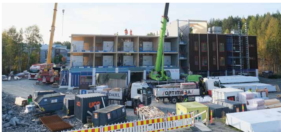
De 48 boenhetene og andre avdelinger i Edvardsløkka Omsorgsboliger blir et plusshus som produserer mer energi enn det forbruker. Energibrønner og et av de første Lowex-systemene i Norge sørger for det.
