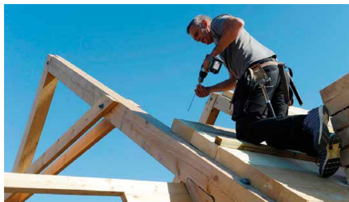
Sutaket er kraftige plank i dimensjon 10 x 30 cm som byggmester Bjarne Harbo her holder på å feste. (Foto Høie Ueland)
