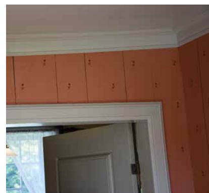
Himlingen skrår fra gammelt av, men ny og forsterket konstruksjon skal stoppe videre synk.
