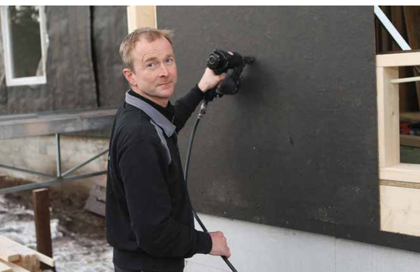
Odd Roar Ryfetten fester plater på veggen i tilbygget.
