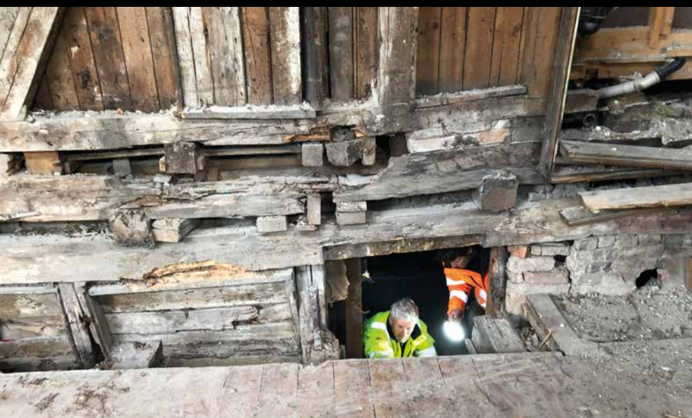
Det viktigste bærepunktet i bygget viste seg å være kav råttent. (Foto: Byggmester Asle Thorsen)
