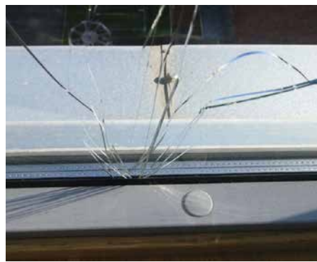
TERMISK BRUDD: Bildet viser et karakteristisk mønster for termisk brudd i glass som ikke er herdet. Sprekken er vinkelrett ut fra skaden og sprer seg deretter i vifteform. (Foto: Glass- og Fasadeforeningen)
