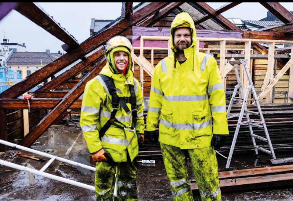
Tømrerne Kenneth Byholdt og Stian Siring har en våt ryddejobb. På taket er aske fra gammel, brent takpapp blitt som lim i regnværet og dekket hele taket og bygningsdeler.
