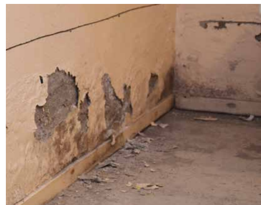
Murpuss og maling som flasser av kjellerveggen, taler sitt tydelige språk om et fuktproblem.
