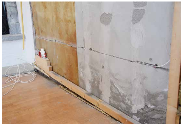
Også innervegger trekker fukt opp fra grunnen.
