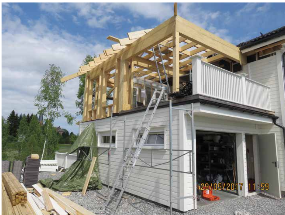
Stiger er eneste atkomst til tilbygget. Stigene er for korte og de er ikke sikret. Stillas lå på byggeplassen og ble først satt opp etter byggestans.
