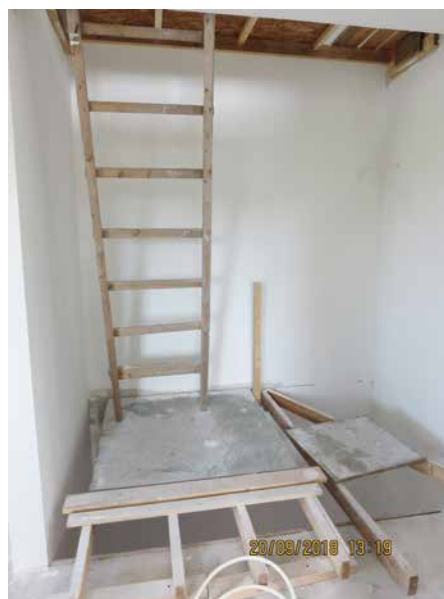
Trestigen står på ei plate over en åpning. Dessuten er den ikke sikret nede.
