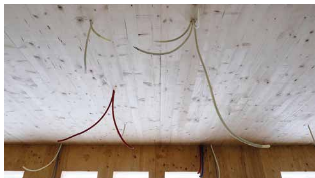
Alle tekniske rør og kabler legges oppå etasjeskillet – som et såkalt datagulv – noe både elektrikere og rørleggere setter stor pris på.
