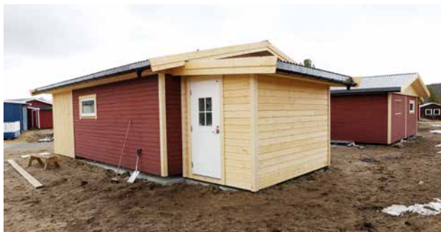
En av de nye hyttene har fått et teknisk rom på baksida.
