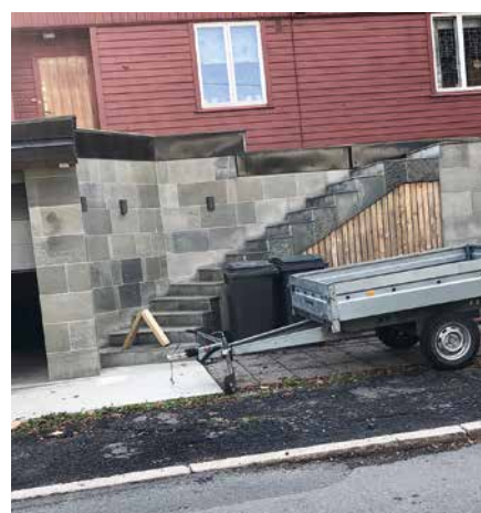
Terrassen over garasjen manglet rekkverk og trappa opp var bare symbolsk stengt med noen plankebiter.
