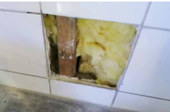
AVDEKKING av baderomsvegg.
