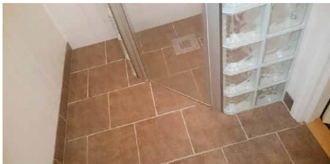
Dusj hvor gulv mangler fall. Resultatet var oversvømmelse ved bruk. Sluk var også feilmontert og manglet membran. (Foto: privat)
