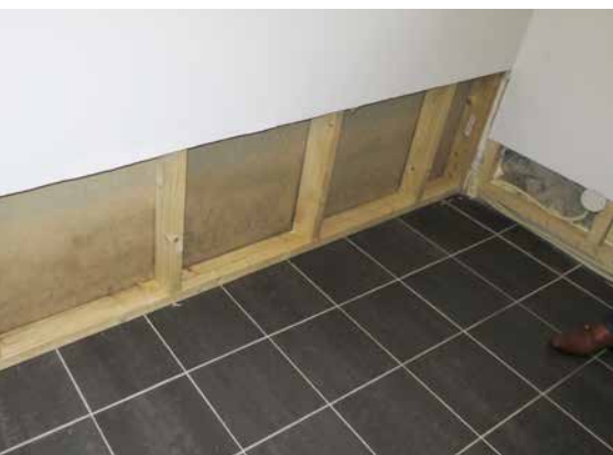
AVDEKKING av lekkasje i innervegg.
