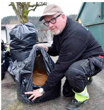
VÅT SAGFLIS: – Sagflisen var brukt som isolasjon og var dryppende våt da vi tok den ut, forteller tømmer Ole Grønvold.
