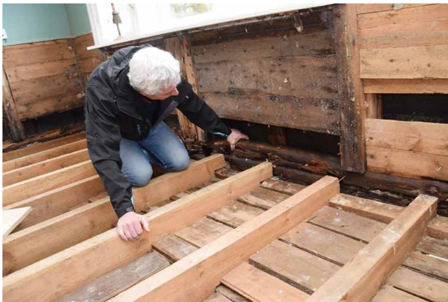
RÅTE: De nederste laftestokkene er gjennombløte og råtne i store partier.
