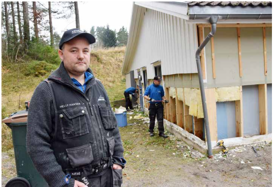
SKADESANERING: – All kledning, plater og isolasjon som sto i flomvann skal bort, forklarer byggmester Kenneth Roland ved renseanlegget der firmaet er i gang med skadesanering.
