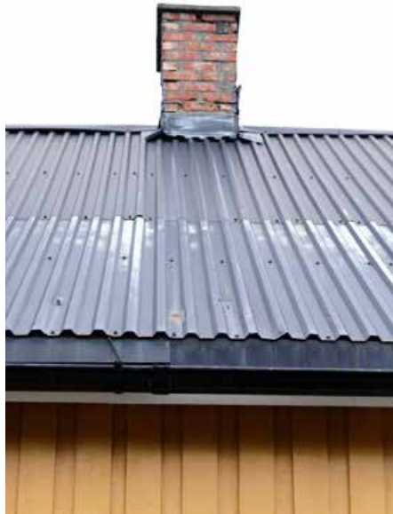
Pipe og løp må kontrolleres av fagkyndig når ny peisovn monteres.
