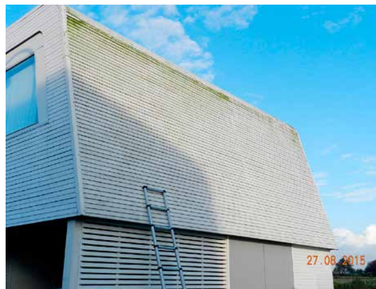
Boliger bygd i 2008. Den skrå endeveggen har liggende kledning. Øverst i vegg ligger det grønske i falsene. Veggene burde vært tekket med båndtekkning.
