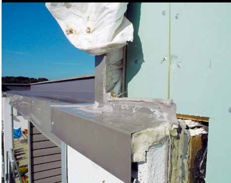
Beslaget er ikke ført inn til gipsen. Fugemasse er lagt i mellomrommet i stedet.
