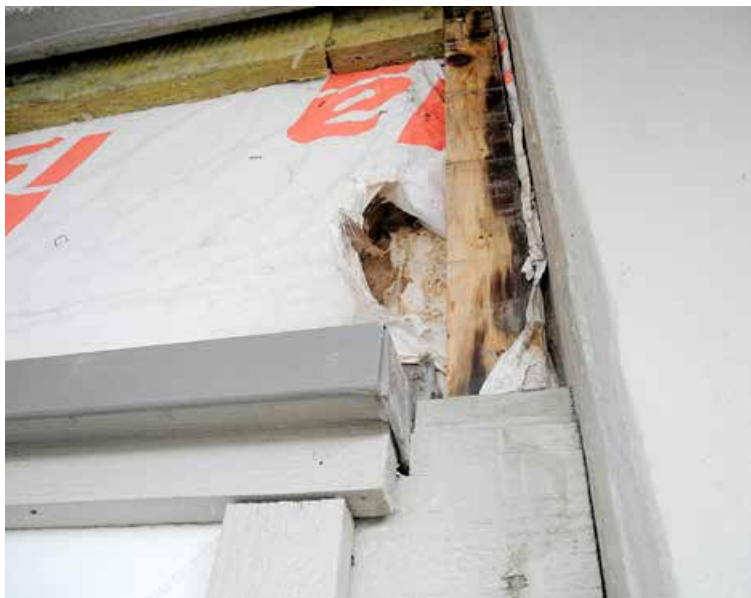
Råtesopp har angrepet stenderen.
