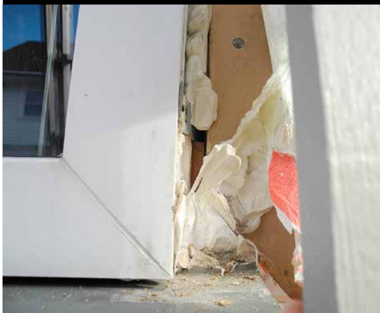
Fugemasse er brukt som lim mellom vindtetteduk og PVC-vinduet, uten suksess.
