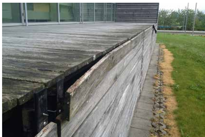
Råteskadene kommer godt til syne flere steder.
