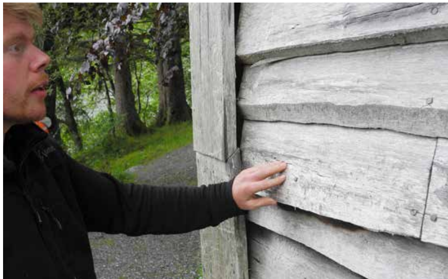
Ospekledningen er den som har klart seg dårligst, konstaterer Ruben Oddekalv som har ansvar for vedlikehold av bygningene på Seletun.
