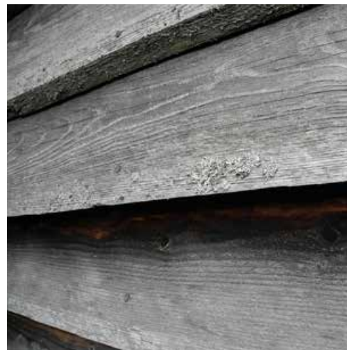
Enkelte bord på noen av veggene er angrepet av lav og sopp, men råteeksperten mener det ikke fører til raskere nedbrytning av veden.
