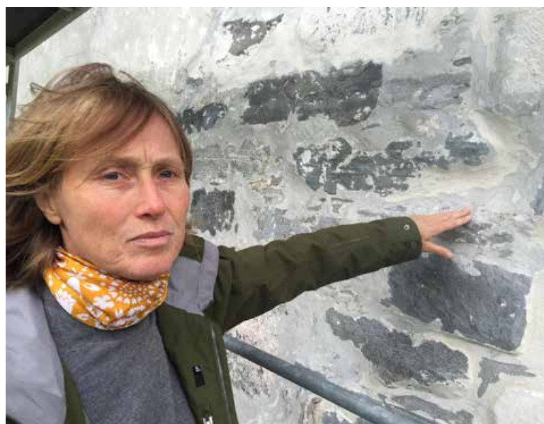
Kirkeverge Marit Linberg viser de uopprettelige skadene på nordsiden av Tingvoll kirke. (Foto: Tommy Fossum)
