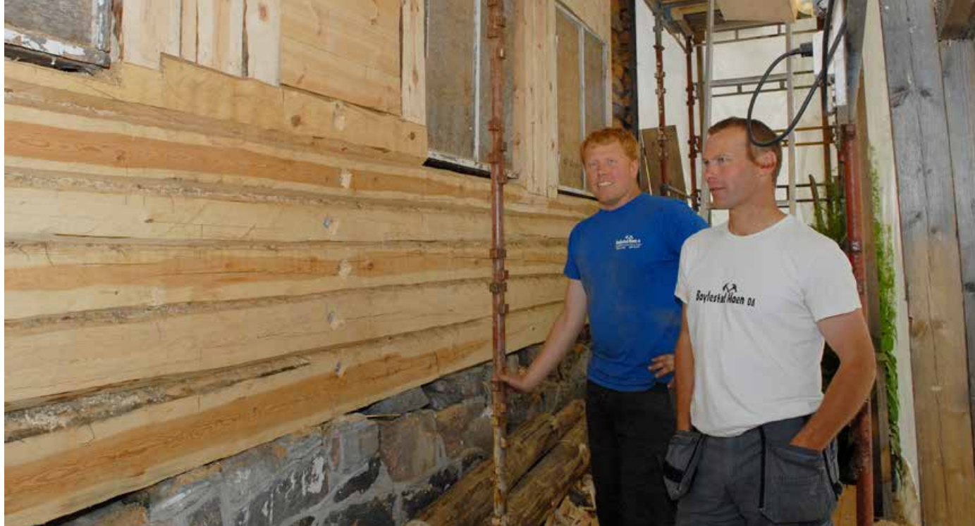
I sørveggen mot sjøen måtte mye råttent tømmer skiftes ut, forteller byggmester Magnus Liene Gundersen (t.v.) og tømmer Ragnar Bøylestad. Jernbolter måtte til for å sikre stabiliteten.
